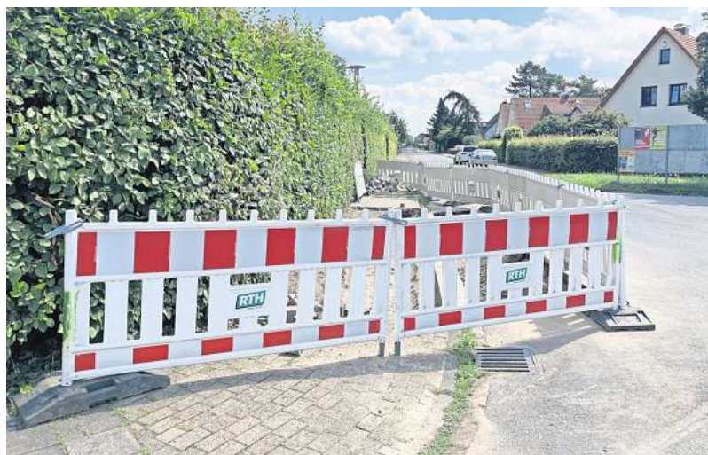
Am Duderstädter Weg tauschen Arbeiter im Auftrag der Avacon ab 2. August die Trinkwasserleitungen aus.
